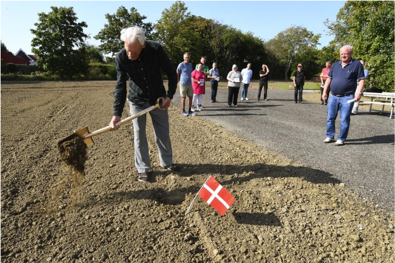
VÆRSKO - SÅ ER DER TAGET HUL PÅ BYGGERIET AF DET NYE VARMEVÆRK I RØDBY. TIDLIGERE FORMAND NIELS ERIK HYLDTOFT TOG TIRSDAG FØRSTE SPADESTIK. (FOTO: JAN KNUDSEN)
